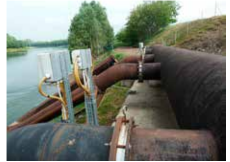
Impianto di sollevamento dal Fiume Adige denominato "Moggia"
